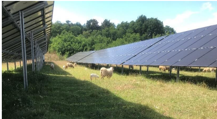
Abbildung 6: Extensive Schafbeweidung im Solarpark
